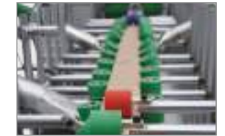
SARMA MODÜLÜ WRAPPING ZONE ЗОНА ОКУТЫВАНИЯ
